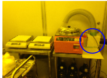
スピンコータ用ダクト
